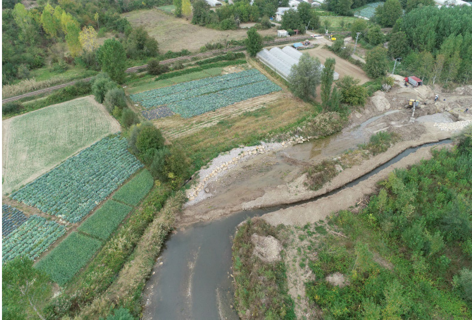
Eskipazar Köyceğiz S.S.T. Sol Sahil Taş Tahkimat ve Sulama Kanalında Borulu Onarım
